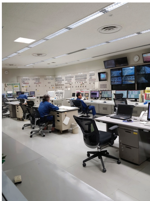
Foto 3 Cabine de controle do incinerador – Tohokubo Clean Center.
