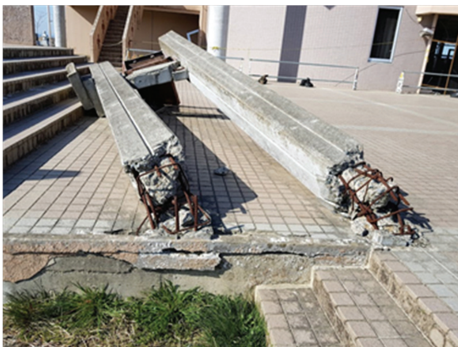
Foto 8 Escola Nakahama – pilares destruídos.
